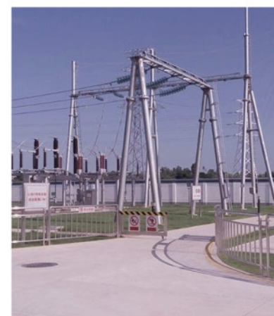
南宁邕洲变电站
